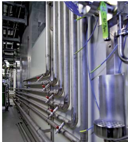
Transferleitungen von den Temperiereinheiten zu den Fermentern
